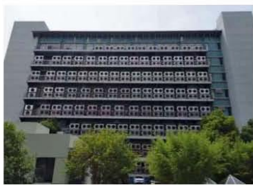
空调室外机实景
